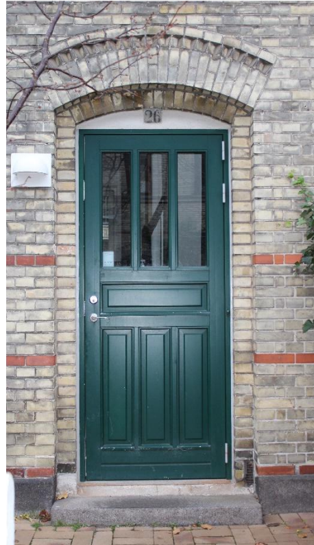
Udadgående dør - i strid med facaderegulativet
